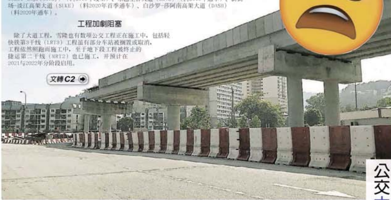
■东巴生谷大道的工程截至12月，料完成45%，目前工程已如火如荼的施工中。(照片取自EKVE网站)
